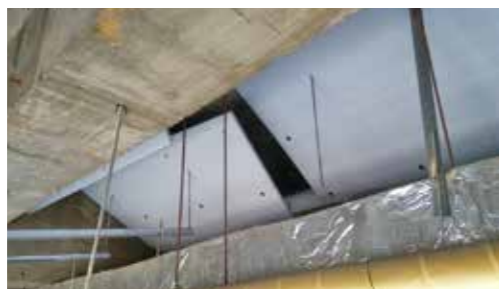
断熱材の剥離が見つかった天井
