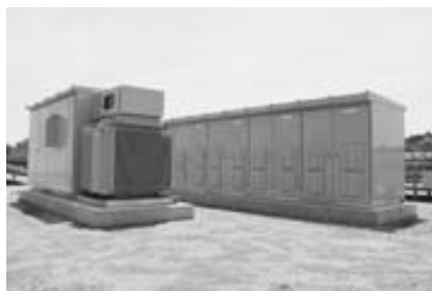
変圧器とパワーコンディショナー
