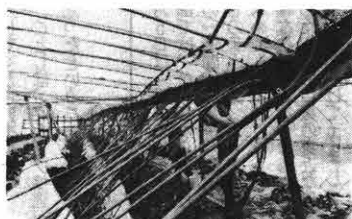
雪の重みでつぶれたビニールハウス
