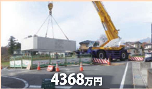
耐震性貯水槽整備事業
