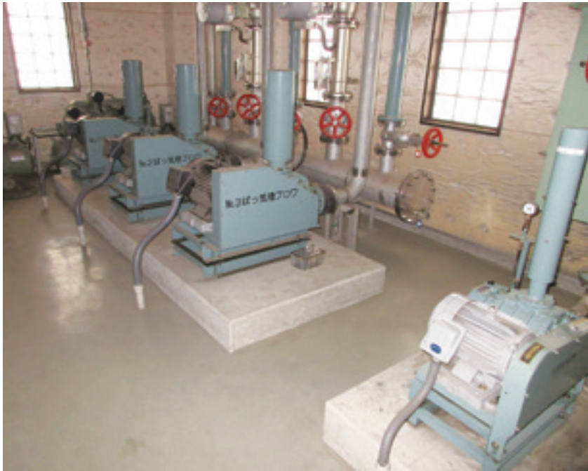
長岡地区農業集落排水処理施設ブロー室
