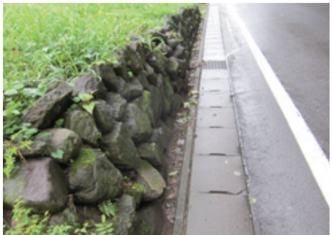
大雨で石垣が倒壊しそうな通学路
