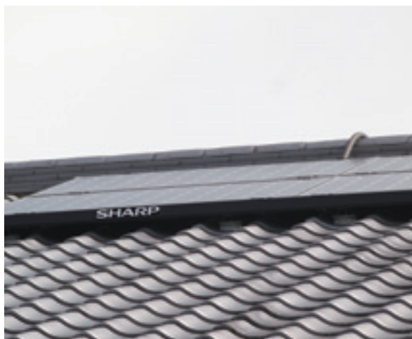
26年度設置の太陽光パネル
