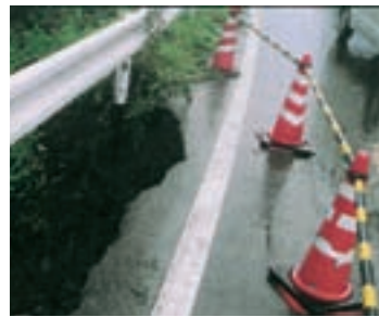
災害現場 横尾4号線 長岡2090-4番地先
