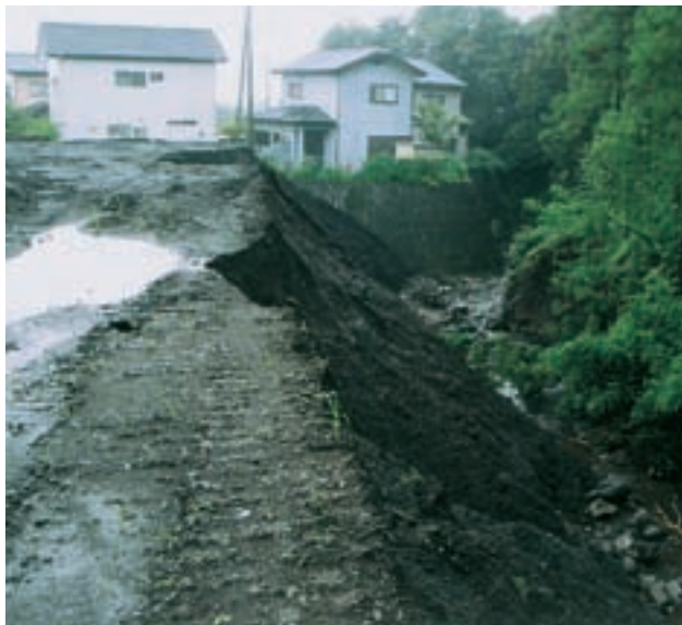
▲災害現場 矢玉沢川 親水公園橋より300m下流
