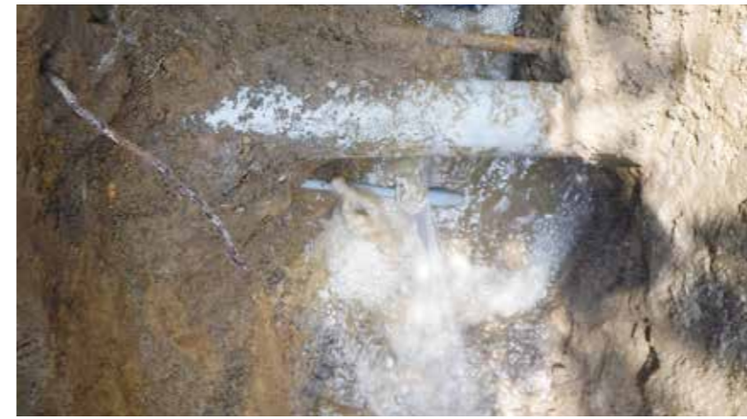
発見した地下での漏水
