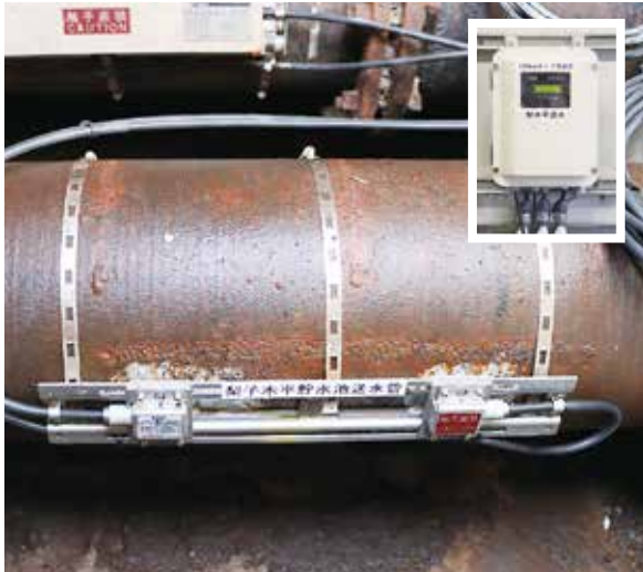
不明水対策で更新した流量計
