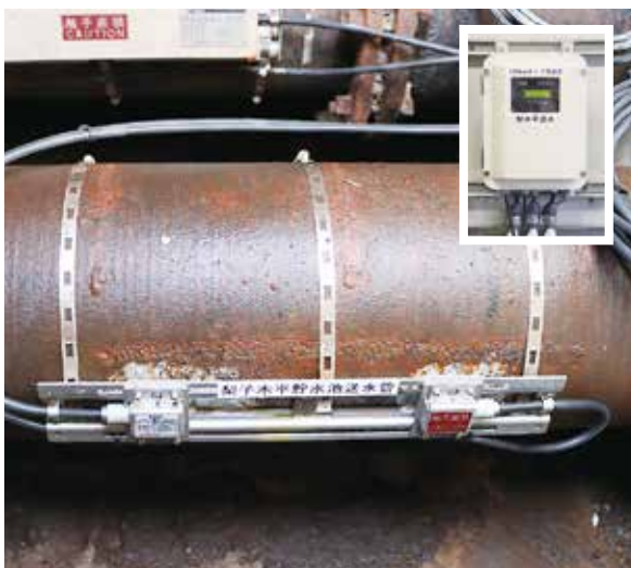
不明水対策で更新した流量計
