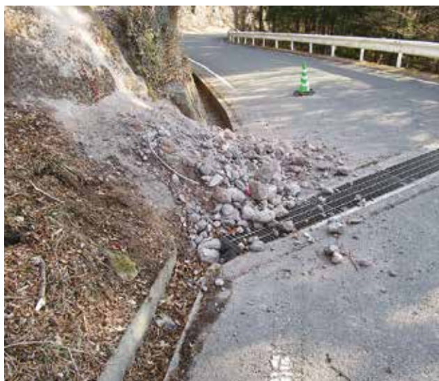
豪雨で崩れた村有林
