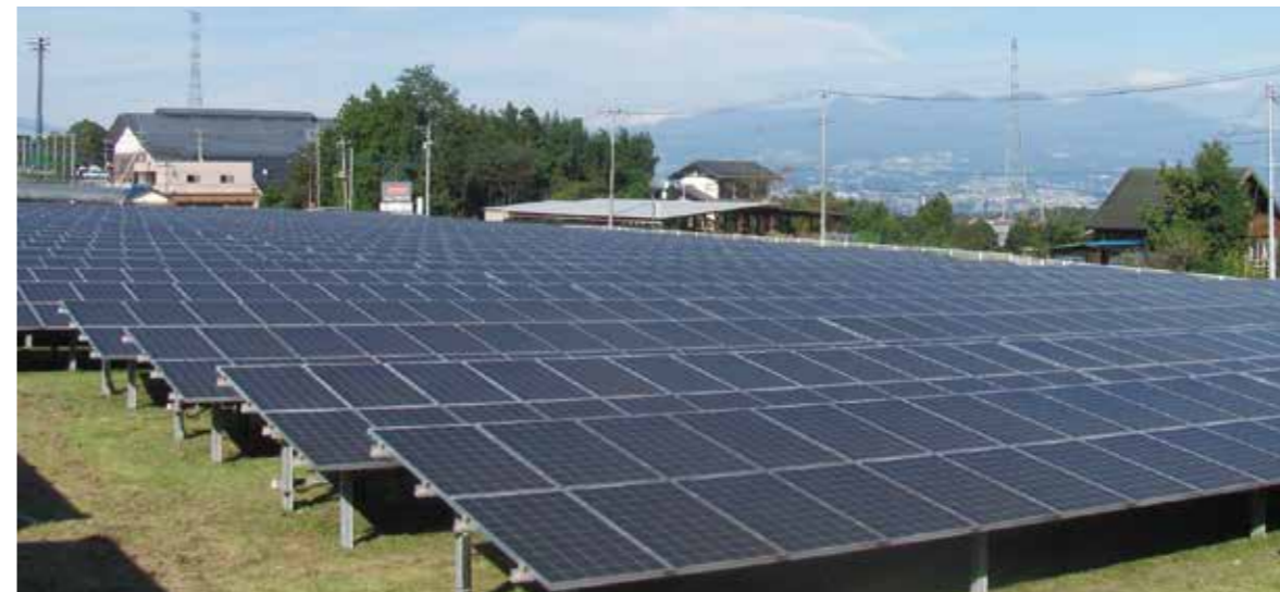
設置後8年が経過した太陽光発電所
