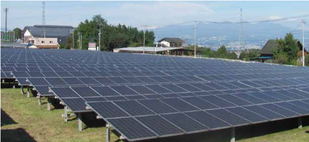
設置後8年が経過した太陽光発電所
