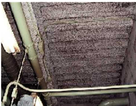
石綿含有吹付けロックウール
