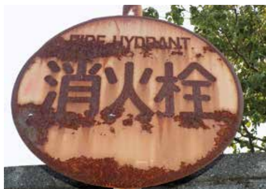
消防水利標識板の劣化による更新を
