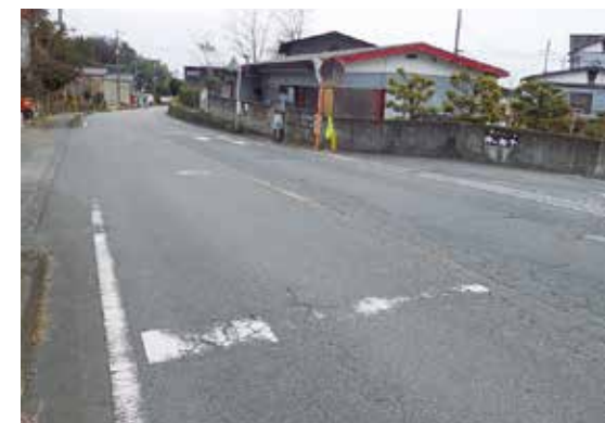
横断歩道と停止線の消えた道路
