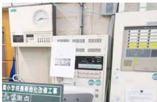
工事前の放送用設備
