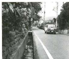
「側溝に溝蓋を」の陳情が出された、長岡地内を走る布海戸一号線
