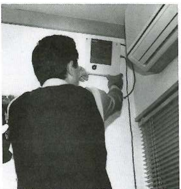
11区と20区に設置された戸別受信機
