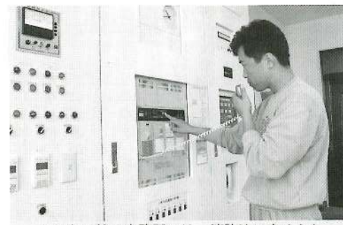
ふれあい館の事務所には、消防法に定められた自動火災報知システムが備えられている
