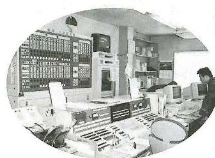
広域消防本部の通信室
